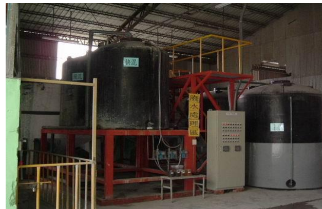
Wastewater Treatment / 廢水處理
